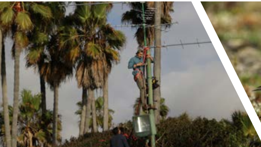
Colocación de Antena, Estero de Punta Banda / Placement of Motus antenna in Estero Punta Banda. • LO
