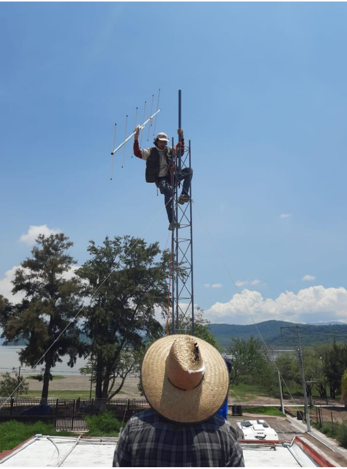
Instalación de arriba a abajo
