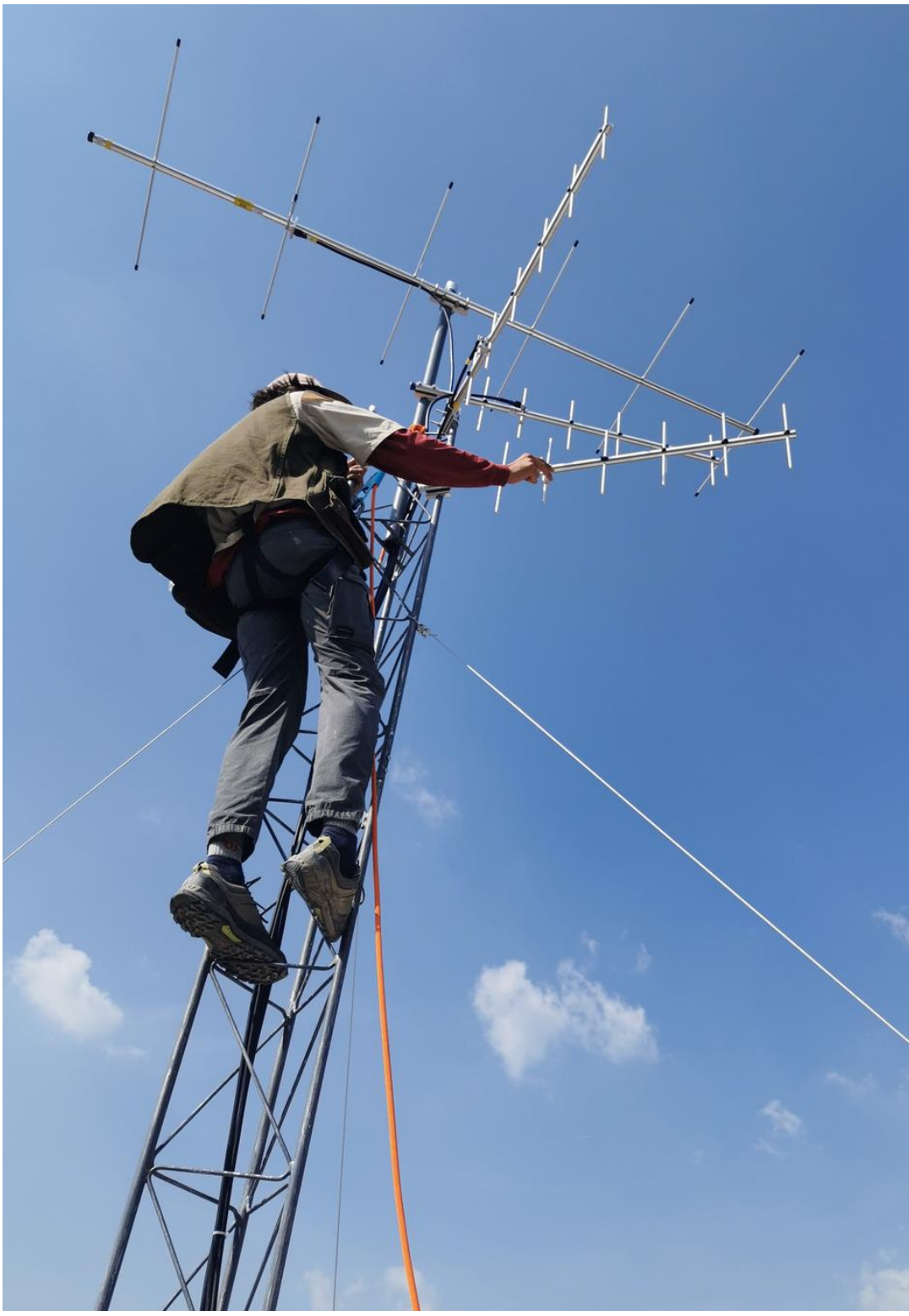
Instalación de arriba a abajo
